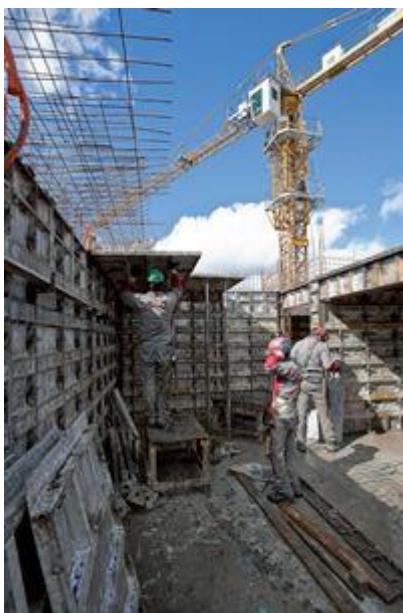
No sistema de paredes de concreto, paredes e lajes são concretadas simultaneamente. Fôrmas são montadas depois que as armaduras e as instalações elétricas e hidráulicas já estão prontas
