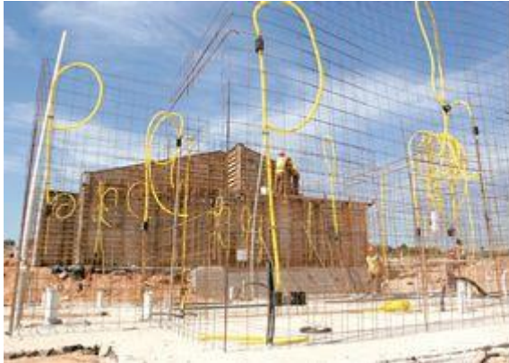
Na maioria dos casos, passagens e tubulações embutidas nas paredes devem ser posicionadas verticalmente
